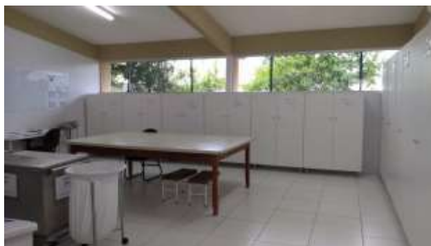
Figura 22. Estrutura rouparia e lavanderia
