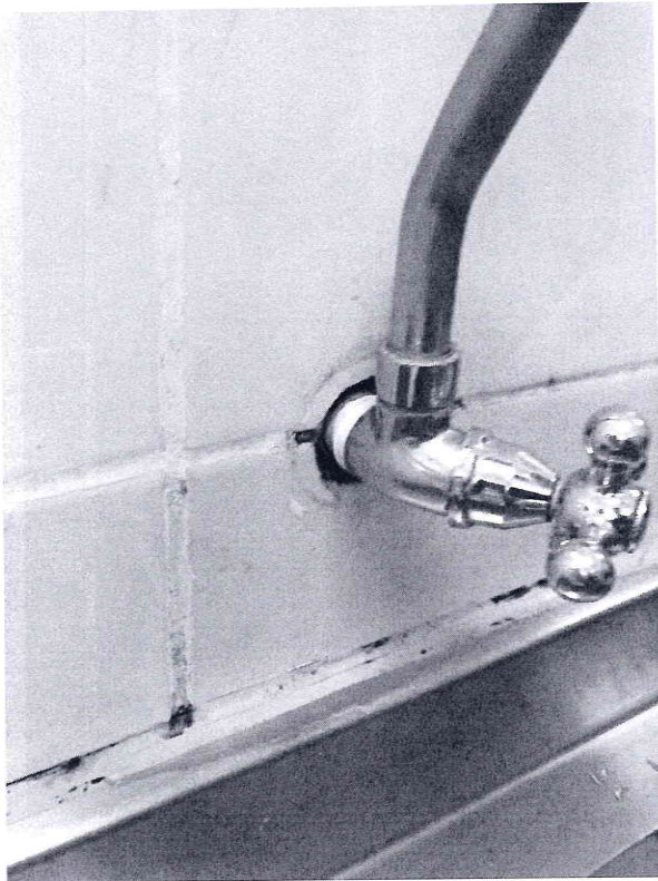
(81) Criado: Wed, 1/8/2025 Cozinha- falha de rejunte e canopla de acabamento da torneira
