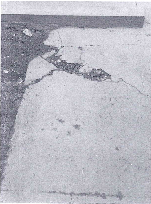
(11) Criado: Wed, 1/8/2025 Calçada interna danificada
