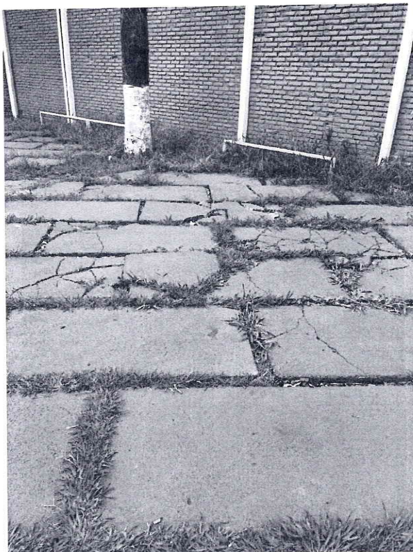
(4) Criado: Wed, 1/8/2025 Calçada danificada
