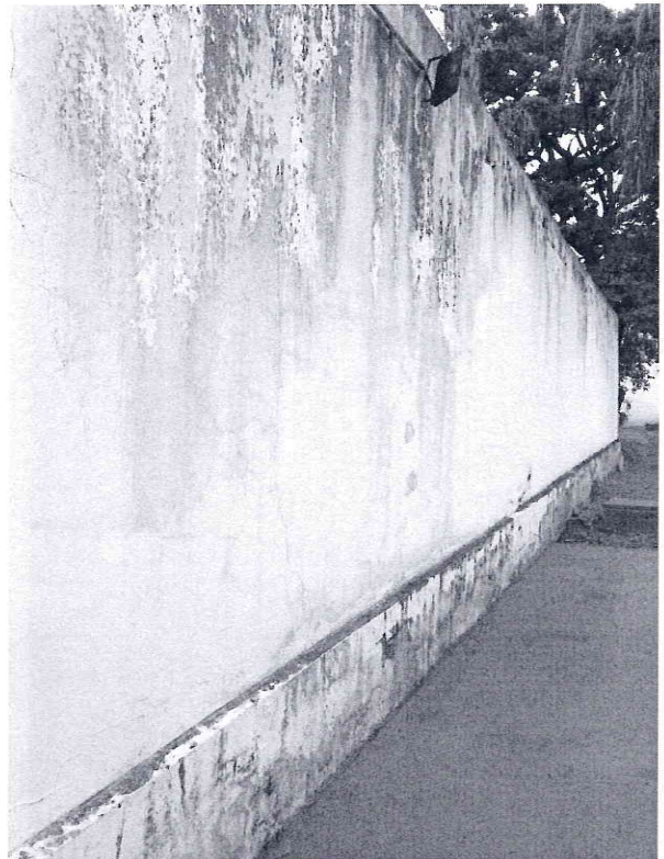
(64) Criado: Wed, 1/8/2025 Muro - pintura desgastada
