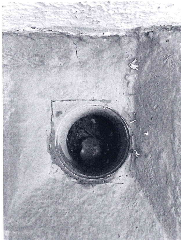
(36) Criado: Wed, 1/8/2025 Sala de mistura de produtos de limpeza - ausência de grelha de vedação do ralo
