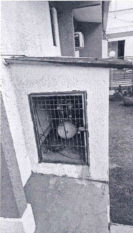
Casa do Compressor
