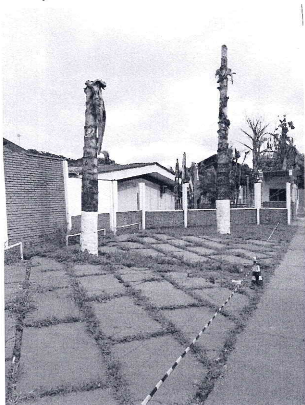
(5) Criado: Wed, 1/8/2025 Calçadas danificada e palmeiras senescentes
