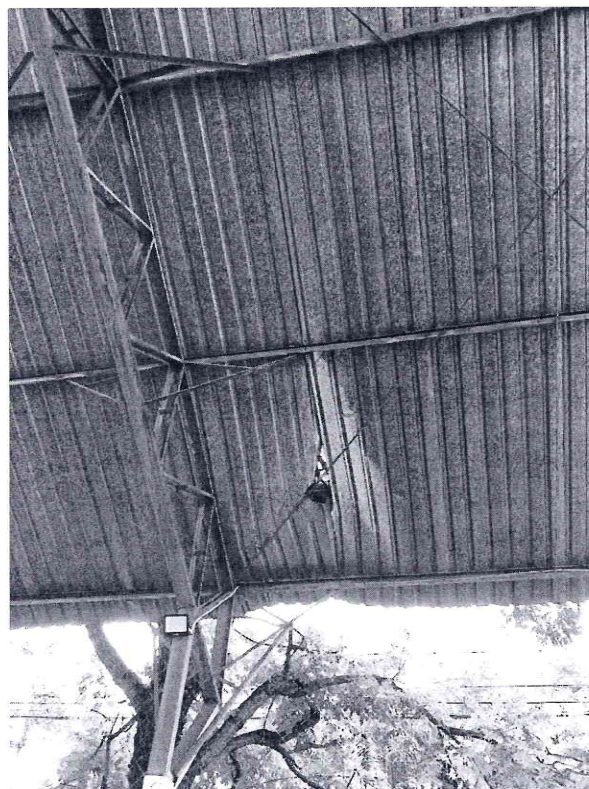
(30) Criado: Wed, 1/8/2025 Cobertura da quadra danificada
