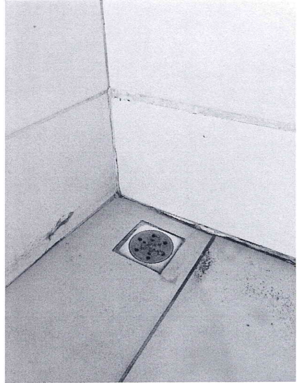
(26) Criado: Wed, 1/8/2025 Vestíário Unisex - Casa de apoio: rejunte com falhas e revestimento danificado
