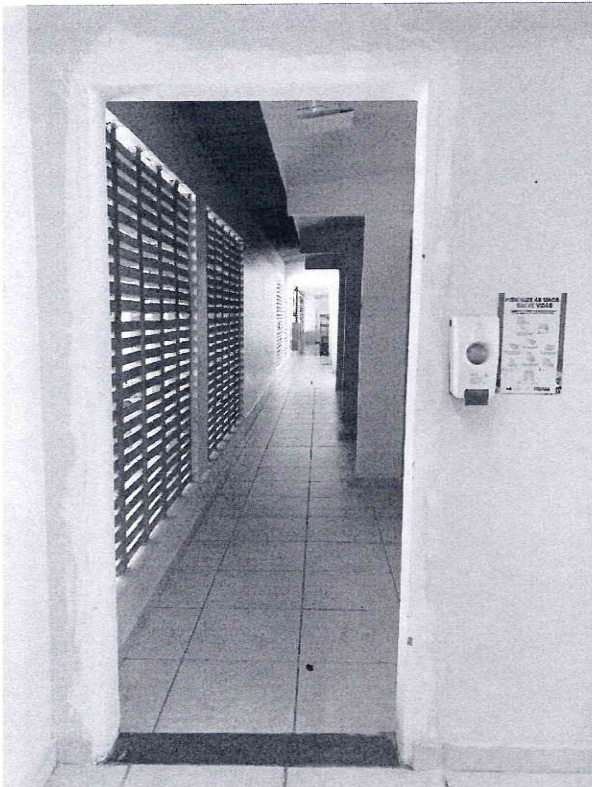
(23) Criado: Wed, 1/8/2025 Refeitório Casa de Apoio - pintura inconclusiva
