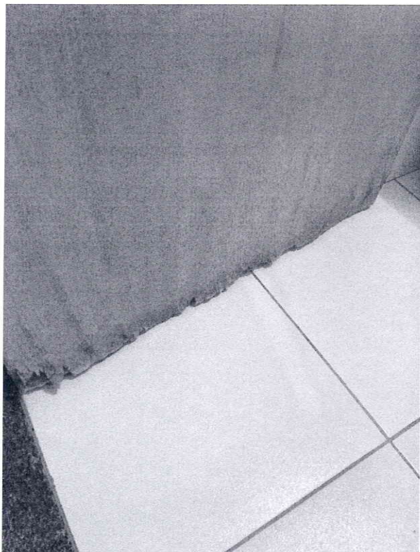
(79) Criado: Wed, 1/8/2025 Cozinha - portas danificadas
