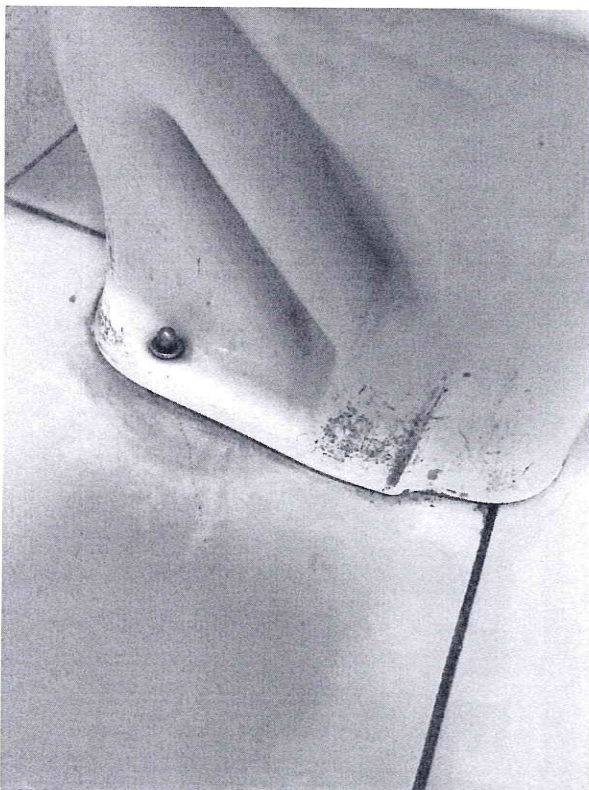
(13) Criado: Wed, 1/8/2025 Bacias sanitárias no geral com falha de rejuntamento
