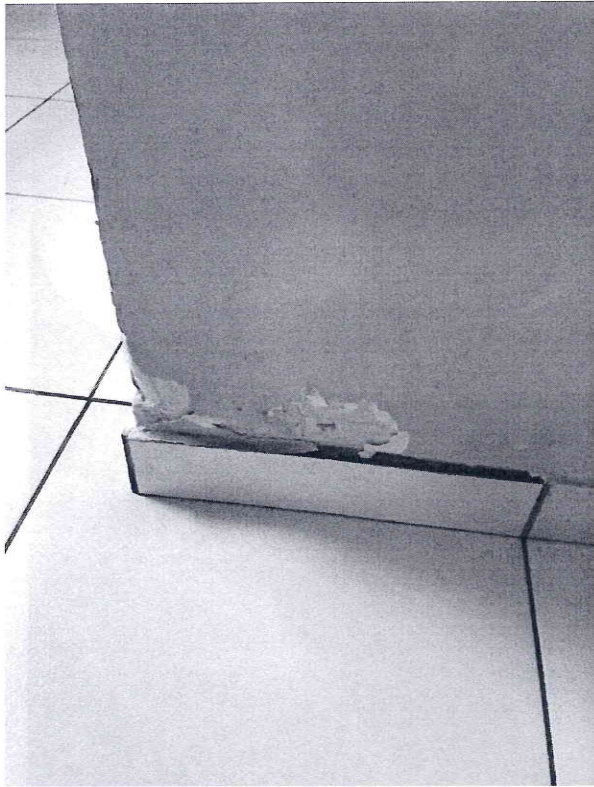
(61) Criado: Wed, 1/8/2025 Corredor de repouso- parede danificada
