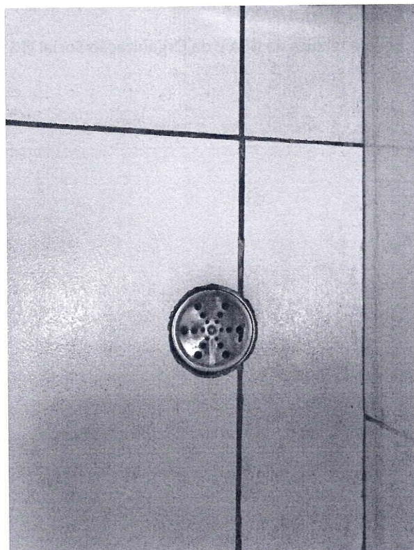
(6) Criado: Wed, 1/8/2025 Banheiro recepção - falha de rejuvenescimento
