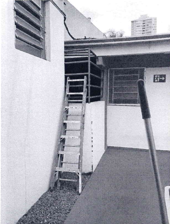
(63) Criado: Wed, 1/8/2025 Cobertura- ausência de acesso da cobertura de forma adequada e em conformidade com as normas
