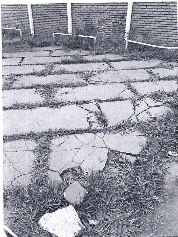
(3) Criado: Wed, 1/8/2025 Calçada danificada
