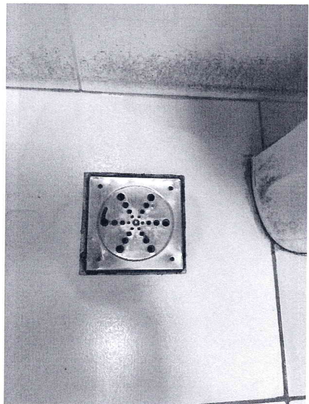
(12) Criado: Wed, 1/8/2025 Ralos no geral com falha de rejuntamento
